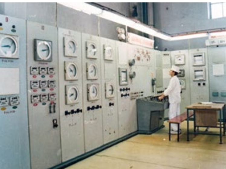
Щитовая в цехе № 1
