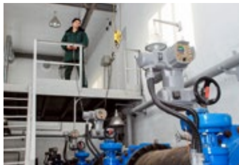
Насосно-фильтровальная станция НЗХК
