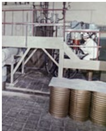
Установка получения углекислого лития в цехе № 6
